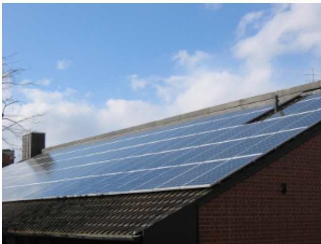
Photovoltaik-Anlage auf dem Kindergarten der Dankeskirche
